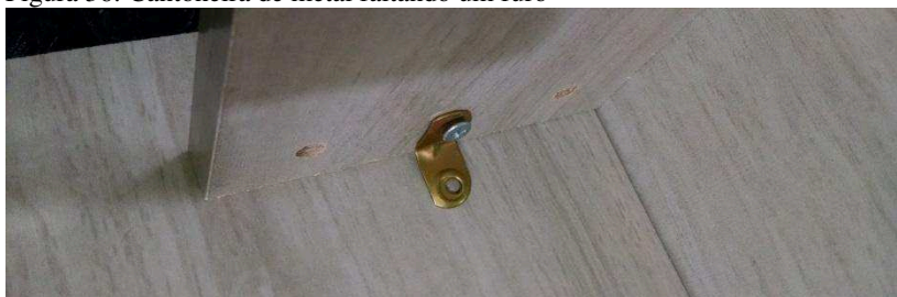
Figura 36: Cantoneira de metal faltando um furo
