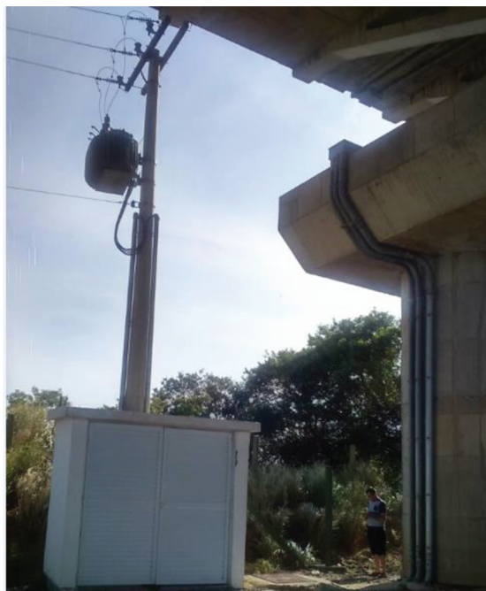
Figura 16 – Alimentação em 13,8 kV cabeceira norte. (Fonte: do autor)
