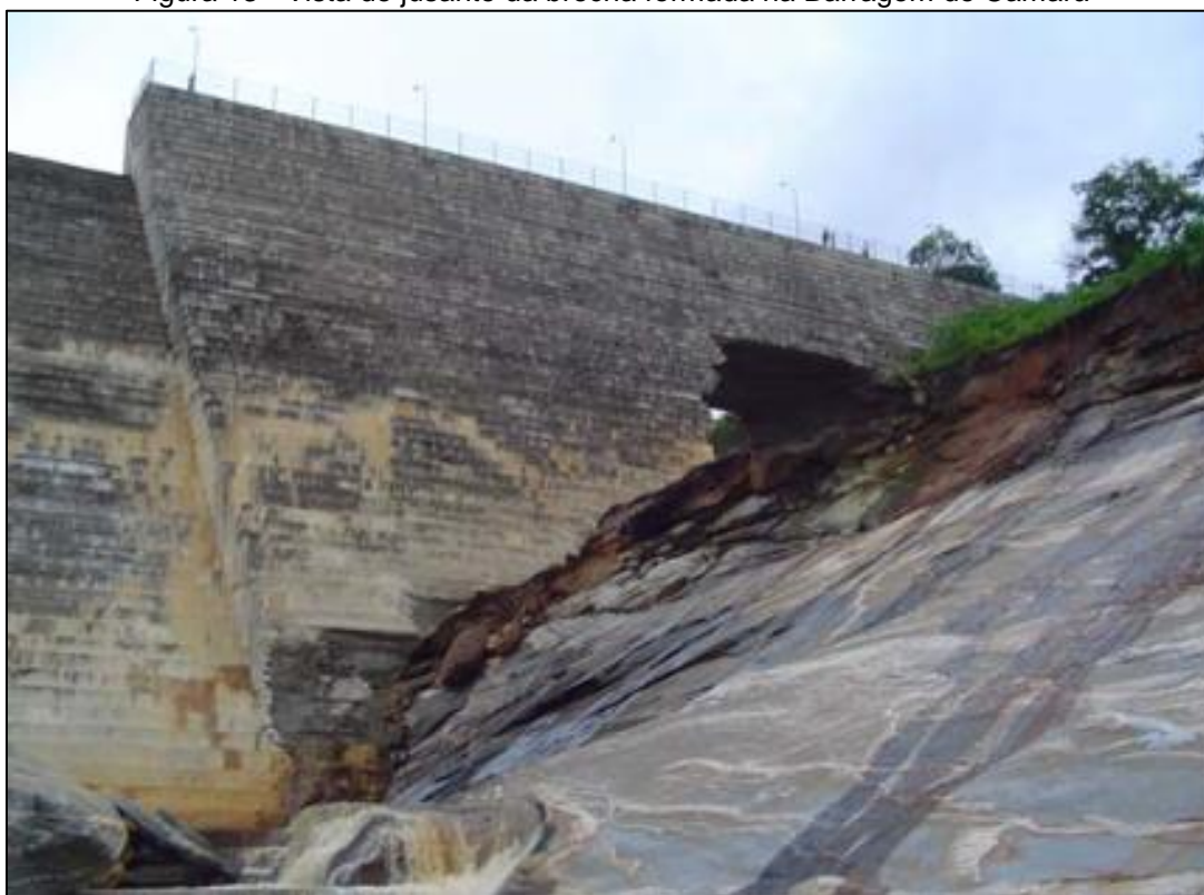
Figura 13 - Vista de jusante da brecha formada na Barragem de Camará
