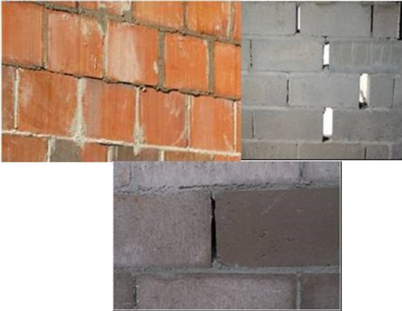
Figura 7.20 – Juntas irregulares com falta de preenchimento nas obras A, B e C.
