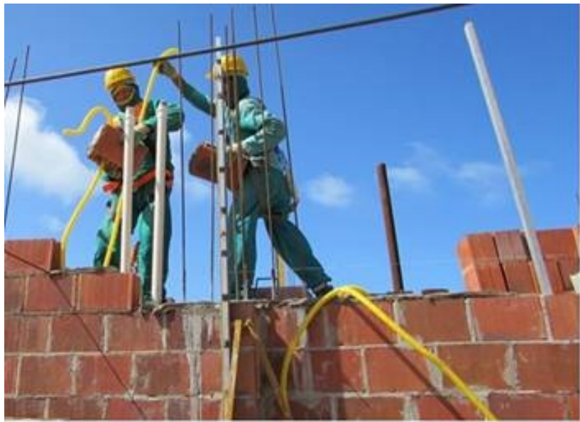
Figura 7.18 – Interferência entre instalação hidráulica e alvenaria na obra A.
