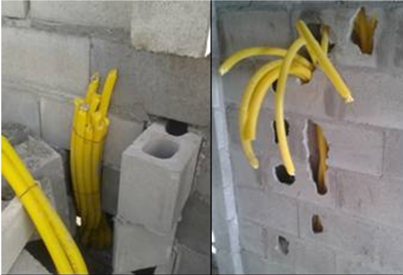
Figura 7.17 – Interferência entre instalação elétrica e alvenaria na obra B.
