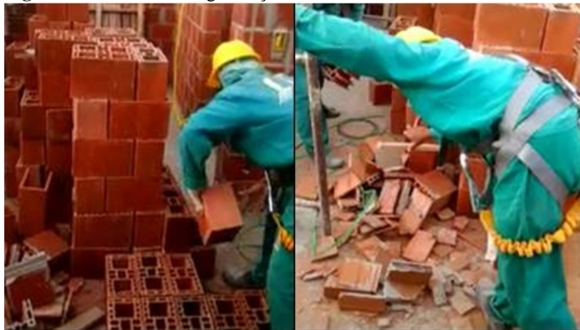
Figura 7.16 – Falta de organização do local de trabalho na obra A.
