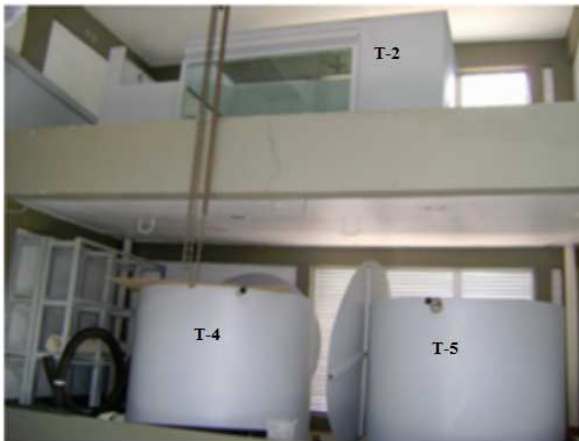
Figura 5 – Tanques Reservatórios T-4 e T-5 e Decantador T-2.
