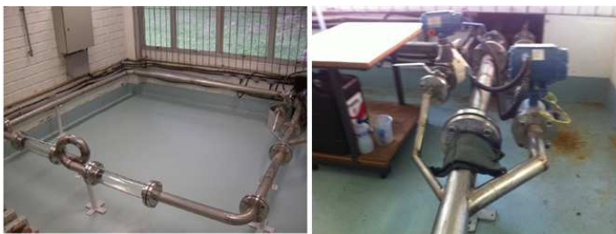
Figura 3 – Sala de Medição.
