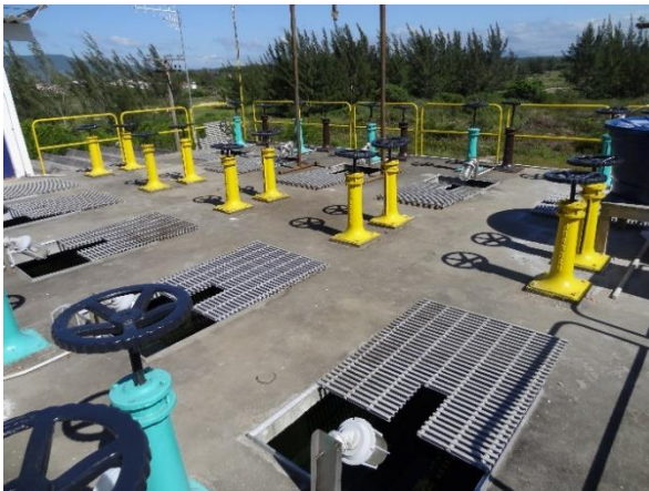
Figura 7. Filtros da ETA.
