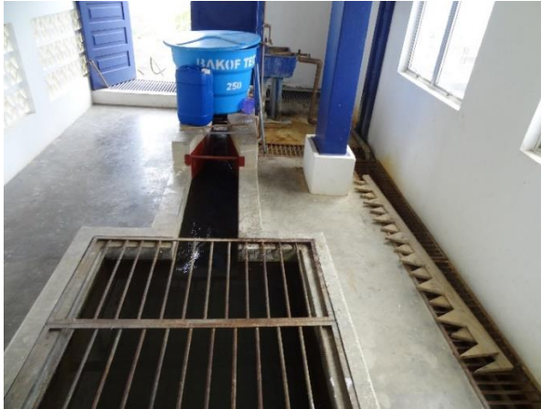
Figura 3. Caixa de amortização e calha Parshall.
