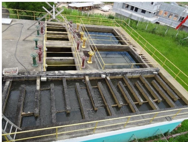
Figura 4. Floculador, decantadores e filtros da estação de tratamento.
