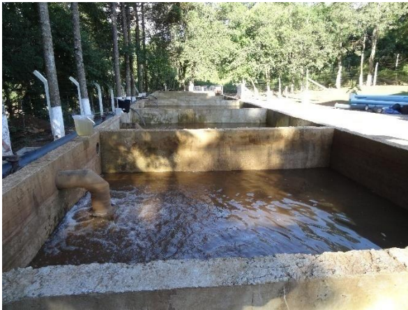
Figura 25. Tanques de sedimentação da ETA.
