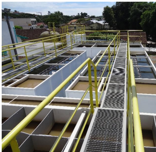
Figura 13. Unidades de tratamento da ETA.
