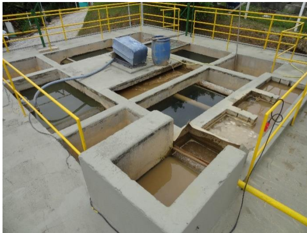
Figura 16. Unidades de tratamento da ETA.
