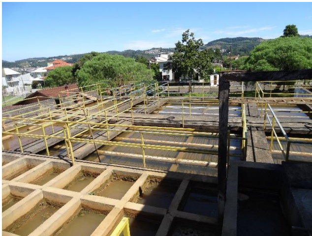
Figura 22. Unidades de tratamento da ETA.
