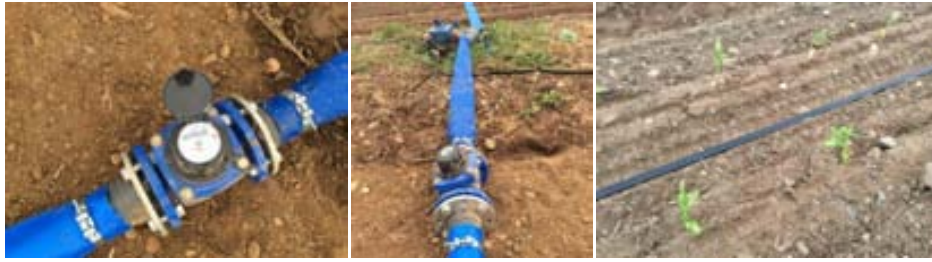
Sonda de medición de la humedad y cintas de riego (Finca Aldea de Conde)
