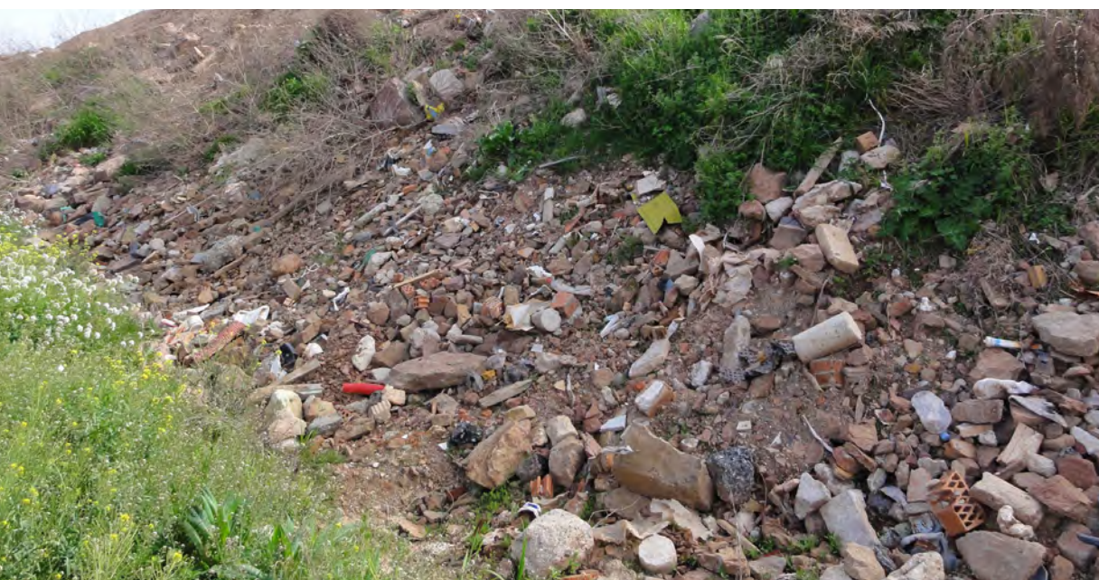
Figura 5. Afloramiento en superficie de residuos de la construcción en un talud de un vertedero en proceso de restauración (foto: V. Carabassa).
