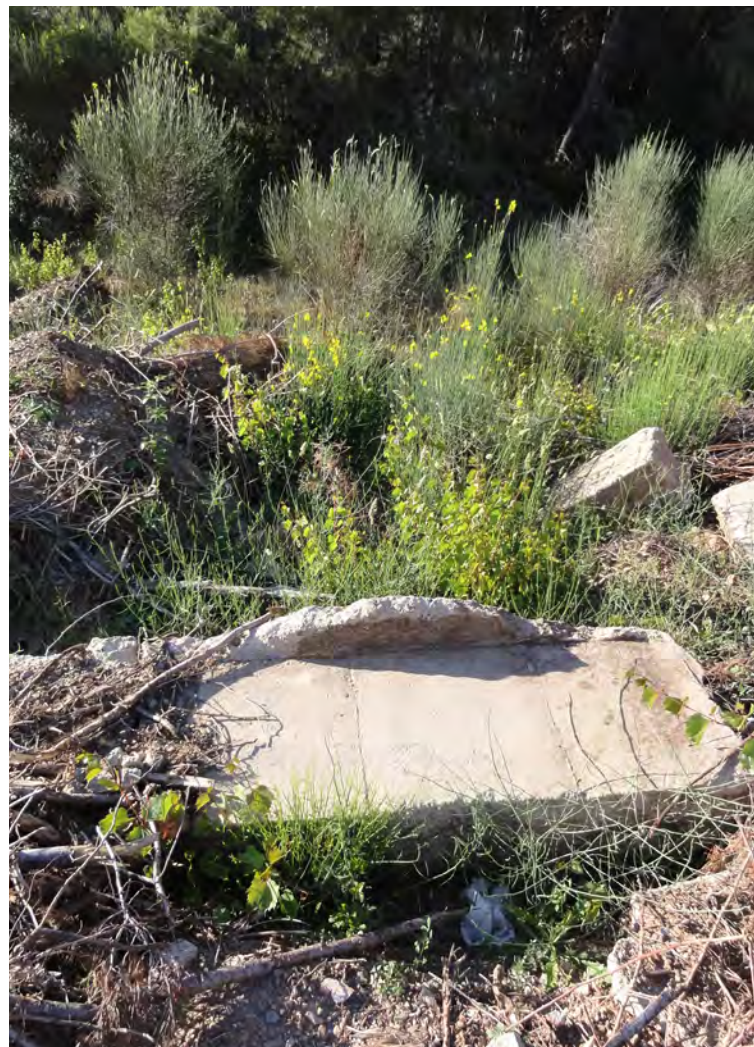
Figura 14. Es importante controlar la presencia de impropios cuando se admiten tierras procedentes del exterior de la actividad extractiva. En la foto: fragmento de hormigón en una zona restaurada que vino transportado con las tierras procedentes de unas excavaciones de obras cercanas (foto: V. Carabassa).
