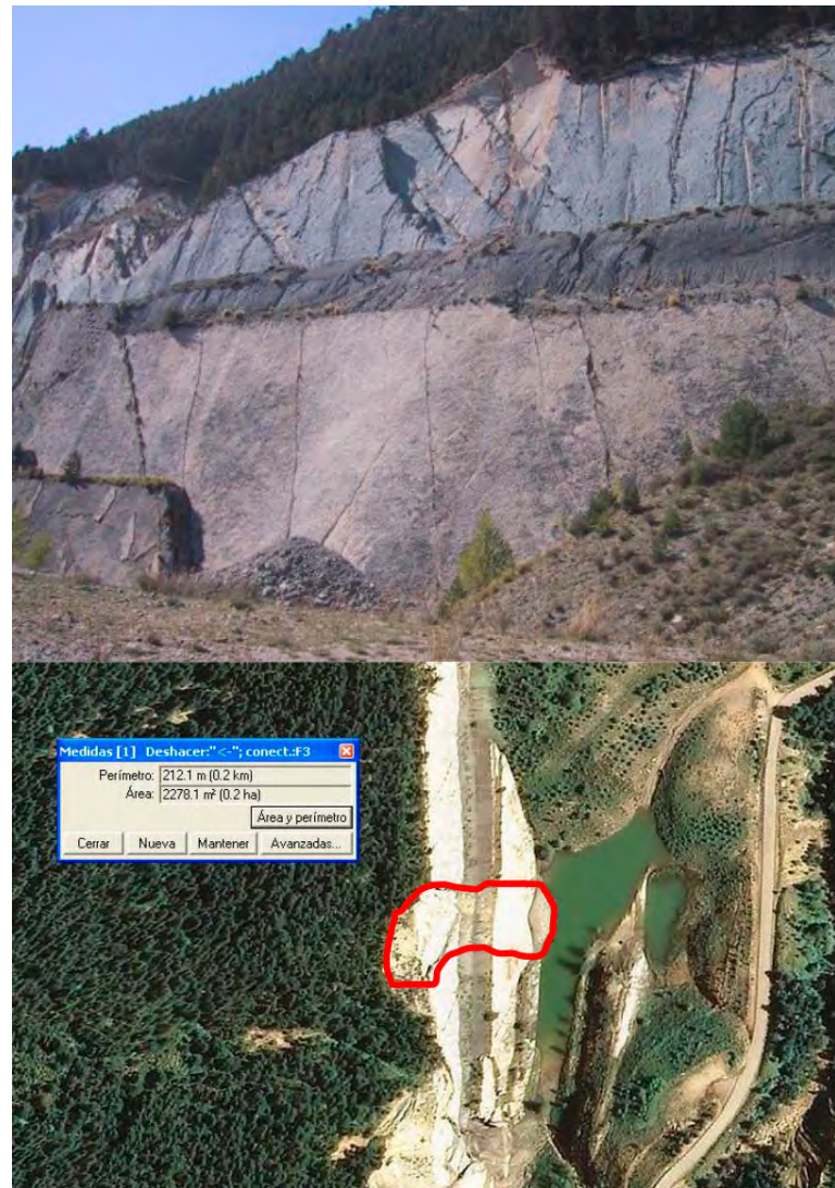
Figura 6. Desprendimiento de bloques en un frente con afectación a la balsa situada en la base. En la imagen de abajo se aprecia la delimitación sobre ortofotoimagen del área afectada, que permite el cálculo de la superficie mediante un SIG (foto: V. Carabassa).
