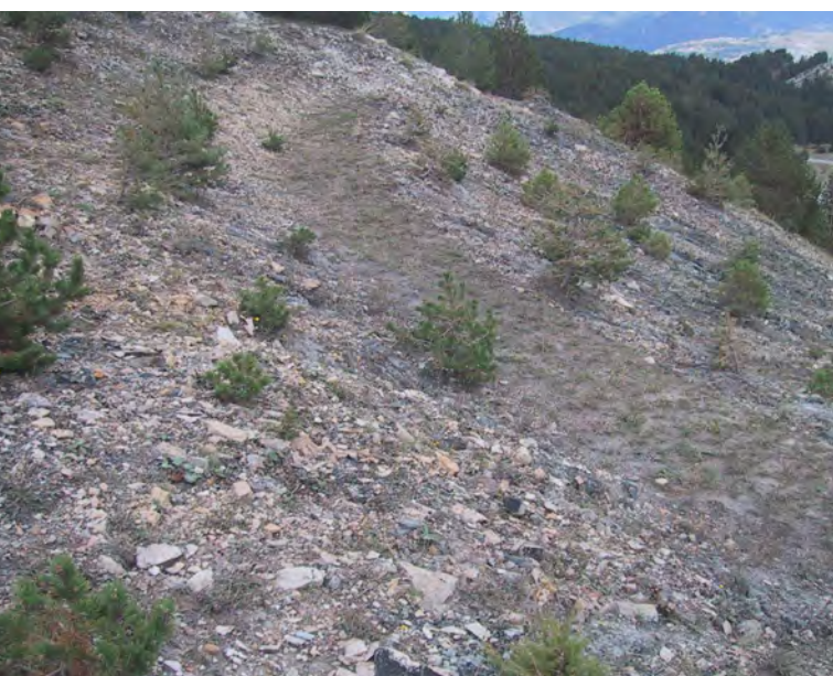
Figura 8. Canal de evacuación de una berma que ha perdido su función al quedar colmatado provocando la entrada de agua de escorrentía en el talud inferior. Cuenca minera de Vallcebre, Barcelona (foto: V. Carabassa).
