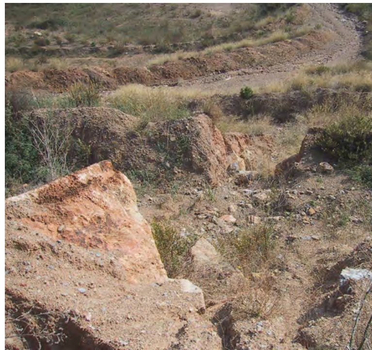
Figura 7. La rotura de las estructuras de control de la escorrentía puede ocasionar graves problemas de erosión que a su vez pueden poner en riesgo el conjunto de la zona restaurada (foto: V. Carabassa).
