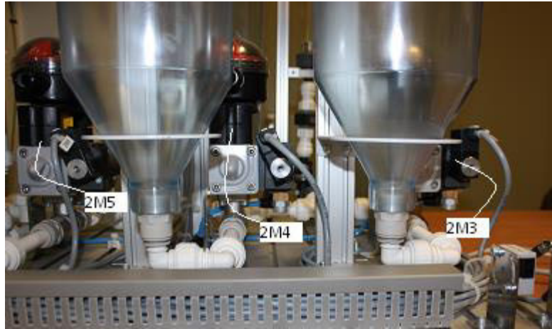
Figura 74. Fotografia localització de les vàlvules de bola de dues vies. Font: Elaboració pròpia.
