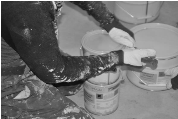
Kuva 31. Epoksiastioiden aukaiseminen ja etenkin kiinni laittaminen likaa käsineitä. Jos käsineitä ei vaihdeta, lika leviää työkohteeseen ja päätyy pinnoilta helposti työntekijän iholle.
