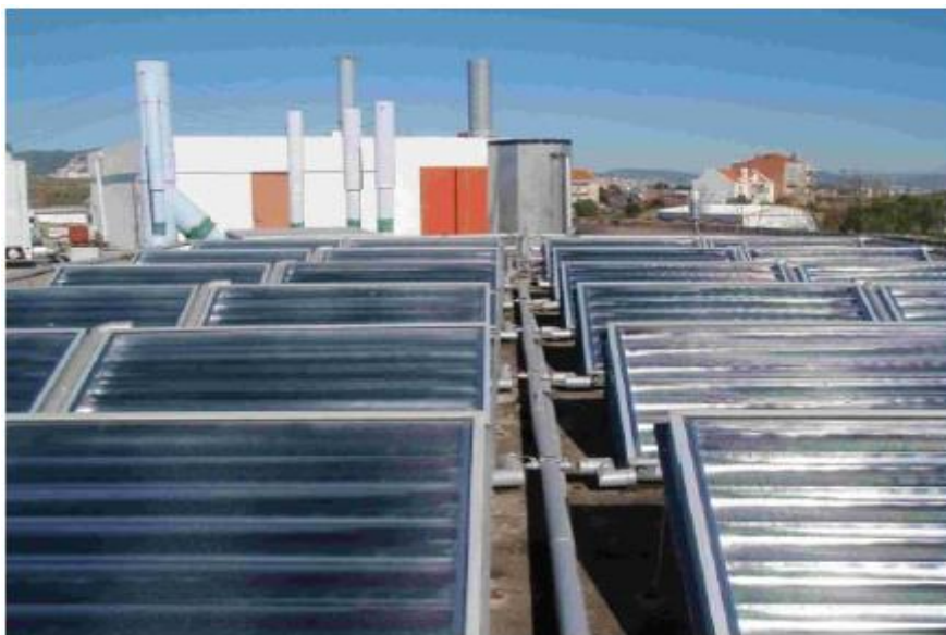
Figura 12 - Sistema de coletores solares térmicos do tipo CPC no topo da cobertura do Edifício G [22].
