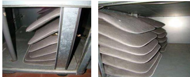
Figura 19 - Filtro de ar na conduta de insuflação (à esquerda) e na conduta de exaustão (à direita).
