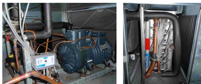
Figura 24 - Evaporador (à esquerda) e condensador (à direita) da bomba de calor.
