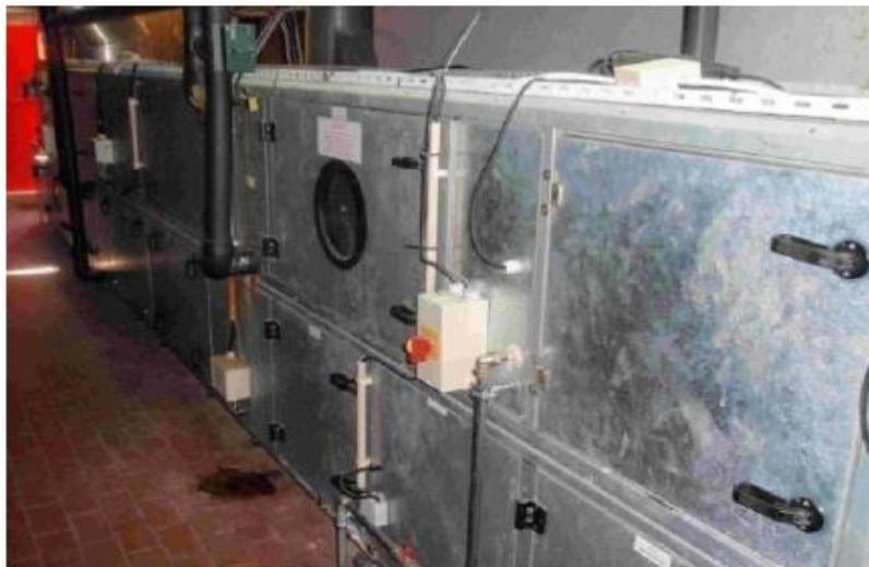
Figura 11 – UTA, localizada na cobertura do Edifício G [22].
