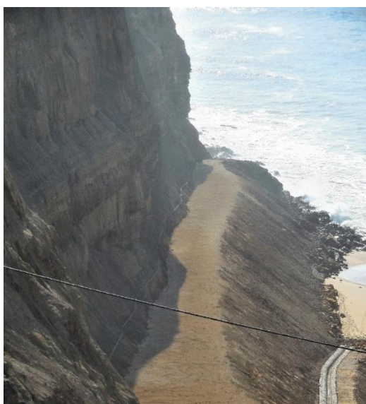
Figura 78 – Exemplo da intervenção para estabilização de zonas instáveis na arriba Sul: saneamento de blocos instáveis, colocação de rede metálica tensionada em cortina e plataforma de retenção escavada nos depósitos de vertente (GeoÁrea, 2011). Imagens de Sónia Queiroz, 19/03/2014.
