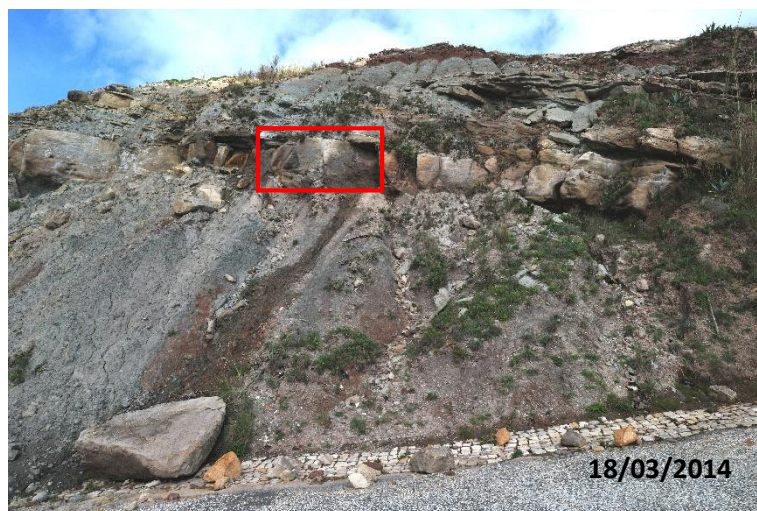
Figura 113 – Imagem do levantamento fotogramétrico após nova queda de blocos– Época 2.
