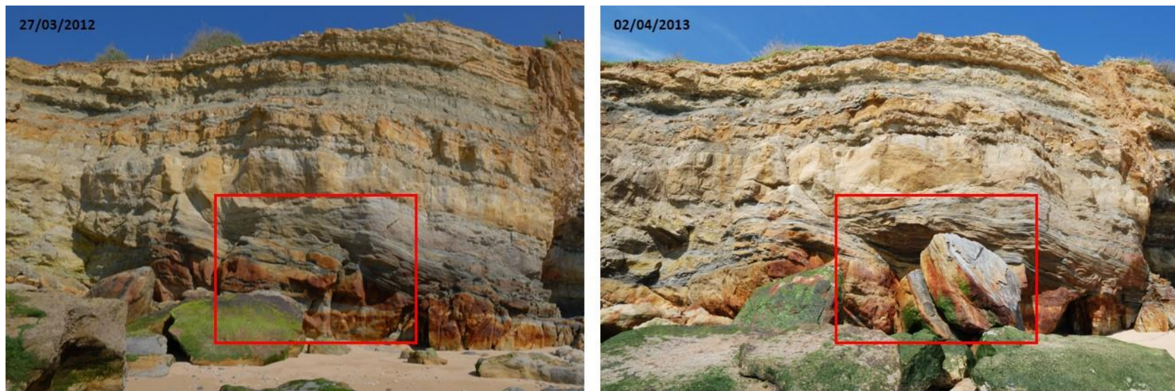
Figura 53 – Exemplo de bloco caído entre épocas de observação, detetado como alteração na nuvem de pontos.
