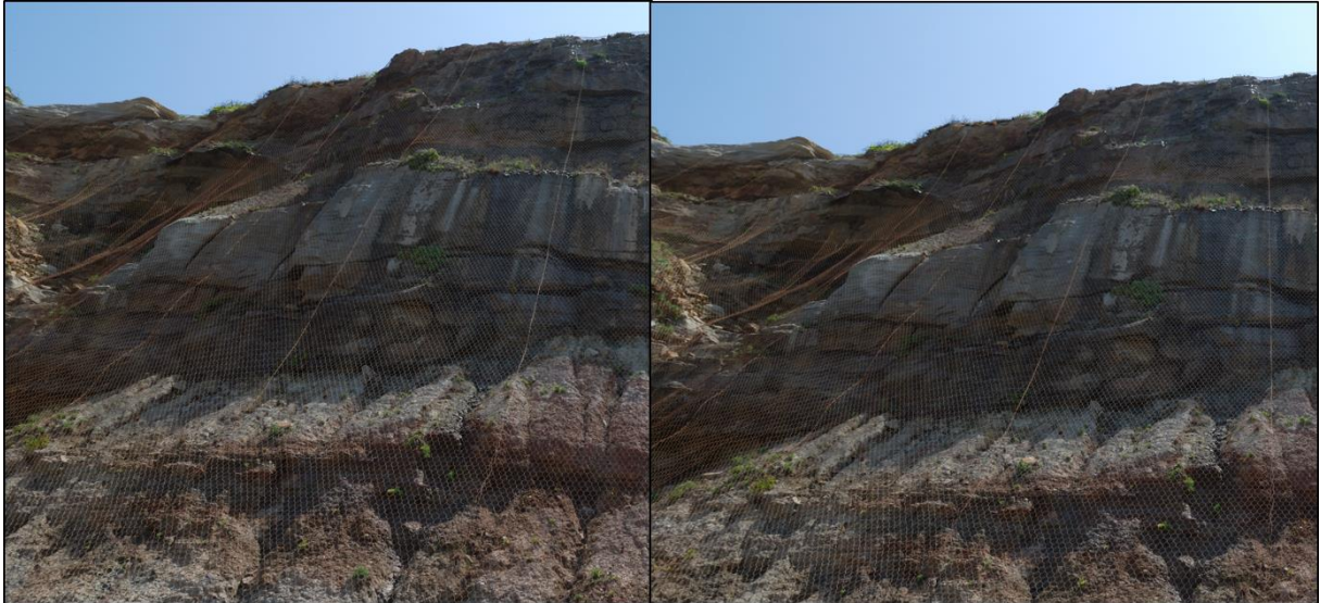
Figura 148 – Reflexos da rede metálica sobreposta à superfície do talude impedem a geração da nuvem de pontos por correlação automática de imagem.
