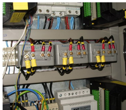
Figura II.52 – Transformadores de Intensidad
