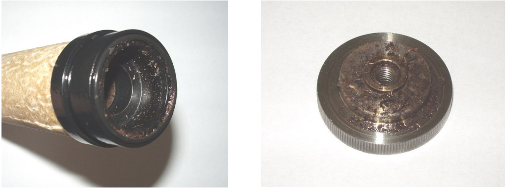
Figura II.62 – Suciedad acumulada en el filtro deshidratados debido a la soldadura oxiacetilénica y restos de teflón
