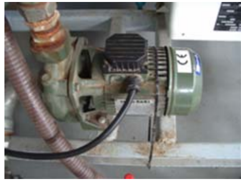
Fig. 4.13 Bomba de empuje del CDC.
