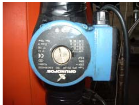
Fig. 4.8 Bomba de recirculación.
