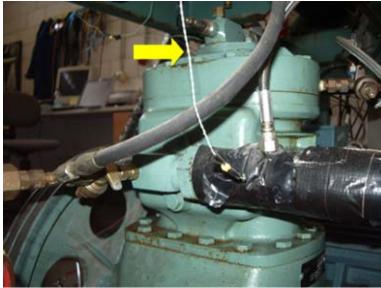
Fig. 4.28 Sonda de temperatura localizada en la aspiración del compresor.
