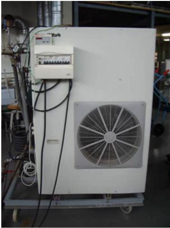
Fig. 4.12 Bomba de calor.
