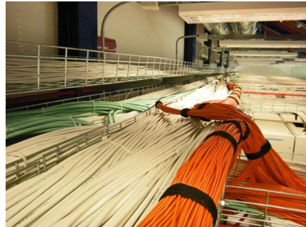
(D) Cables above the racks.
