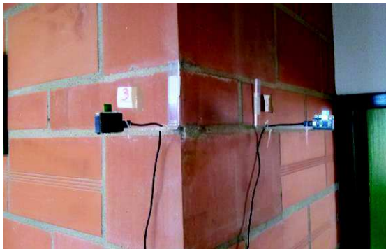
Figure 4. Nœuds DecaWave fixés au mur
