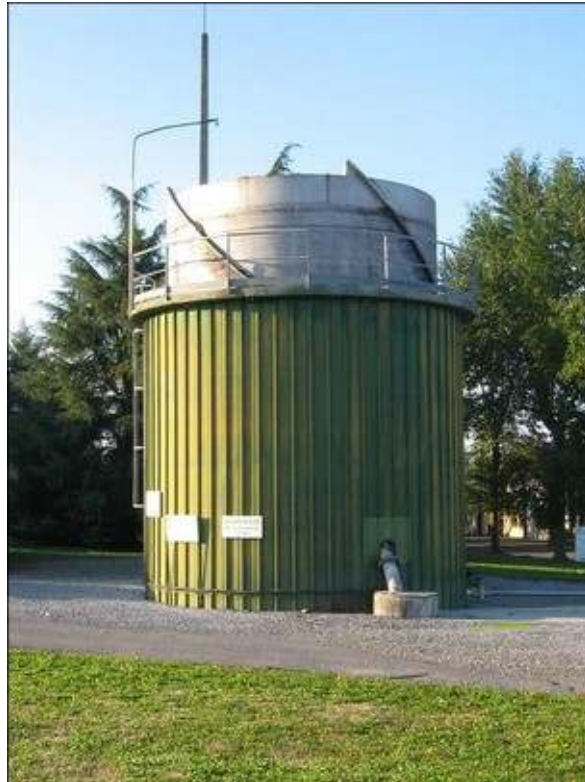
Photo 3 : Unité de méthanisation (digesteur)
