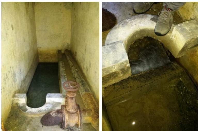
Figure 2.14: Fotografie della captazione
