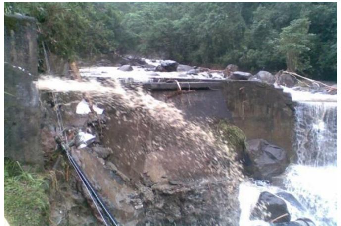
Figura 13. Creciente río Piedras con afectación a la bocatoma del Acueducto de Popayán, año 2008.
