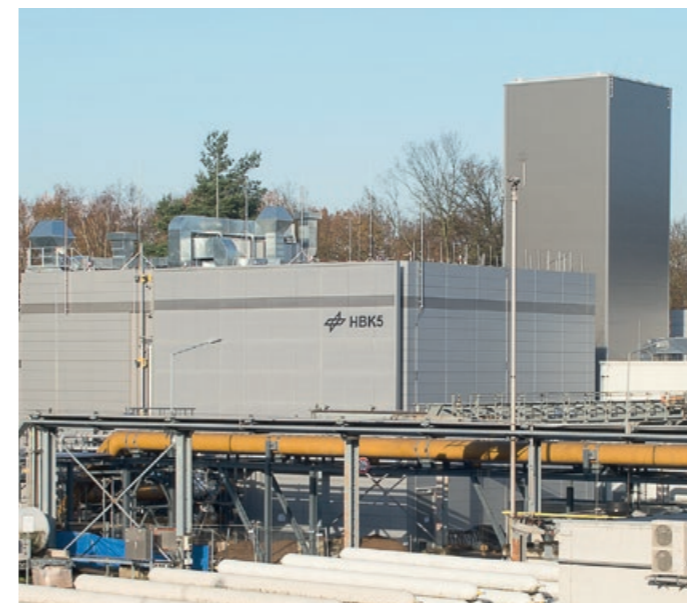
Auf dem Hochdruckbrennkammerprüfstand HBK5 im DLR Köln können komplette Brennkammern unter realitätsnahen Bedingungen erprobt werden
