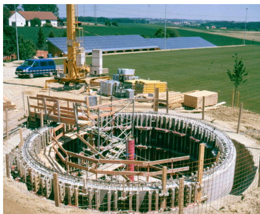
Abbildung 2 Erdbeckenspeicher des Projekts „Solare Nahwärme Attenkirchen“
