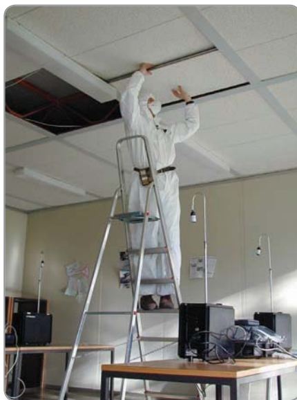
Figure D.11: Des mesures représentatives aux postes de travail impliquent le prélèvement d'échantillons sur des hommes/femmes. Pour cela, on utilise des pompes légères et portatives qui aspirent l'air de la zone de respiration à travers un filtre à particules.
