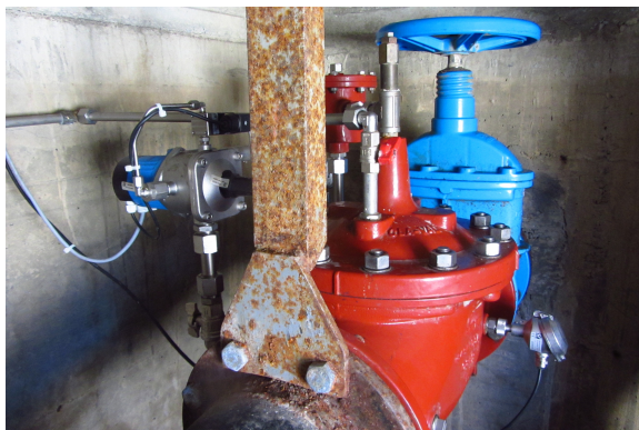
Figure 2. Sonde e-FlowMeter (à droite de l'image) insérée dans un coupe-pression du réseau d'irrigation, en amont du vignoble de Montana. Photo : Martin Calianno.
