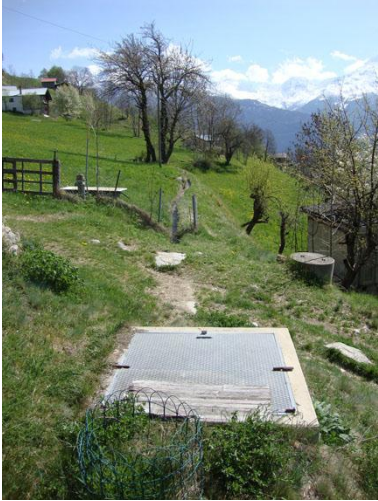
Verteiler und Einmündung vom Rohrstück zur offenen Kanalleitung bei Steigrächa
