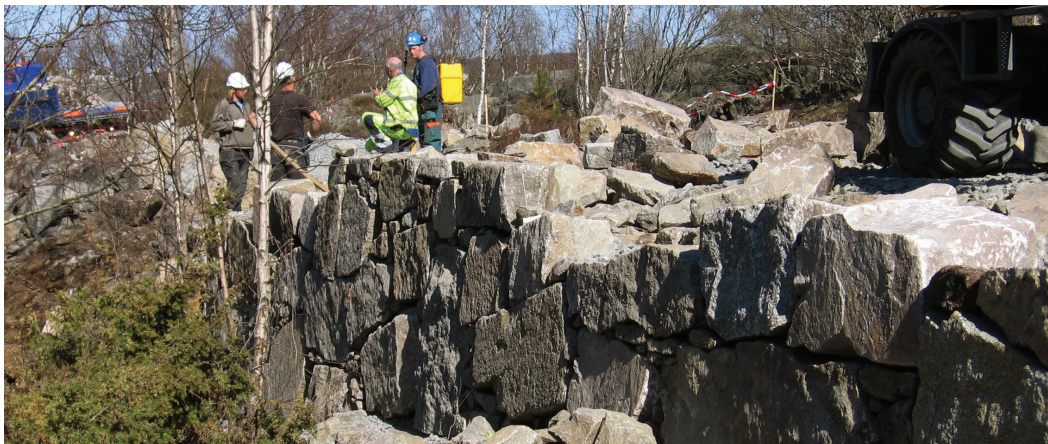
Bortsprängt berg kan återanvändas i olika funktioner vid en exploatering av ett område. Foto: Ramböll Sverige AB.
