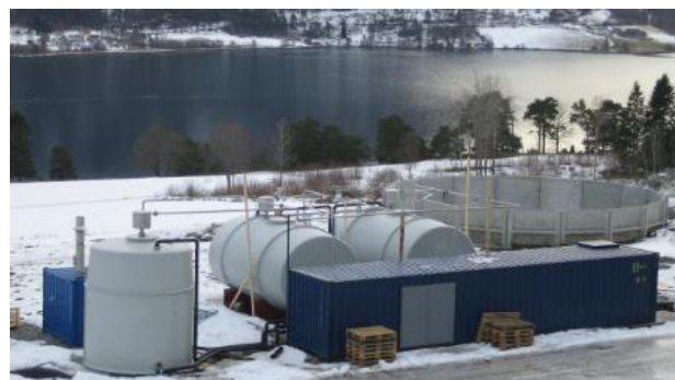
Gårdsbasert biogassanlegg for husdyrgjødsel på Tingvoll ved oppstart. Tankene er senere isolert og anlegget er bygd inn. Foto: NORSØK
