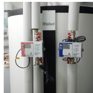
Abbildung 7.3: Messgerät zur Erfassung des Trinkwasserverbrauchs und der Zirkulationswärmeverluste Foto: TUD, FG twe
