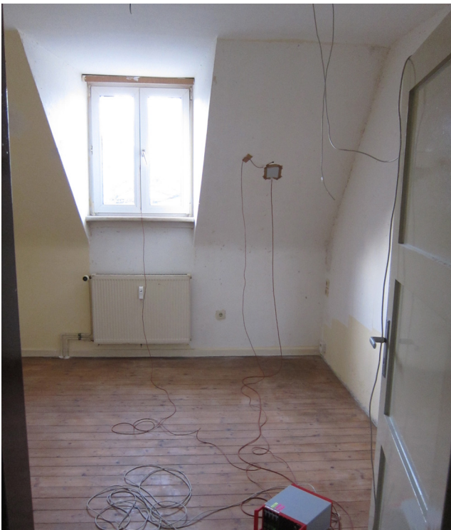
Abbildung 8.16: Innenraumaufnahme der U-Wert-Messung des Daches im unsanierten Fritz-Dächert-Weg 56-58. Die Abb. zeigt die Wärmestromplatte und den innenraumseitig angebrachten Oberflächentemperaturfühler.
