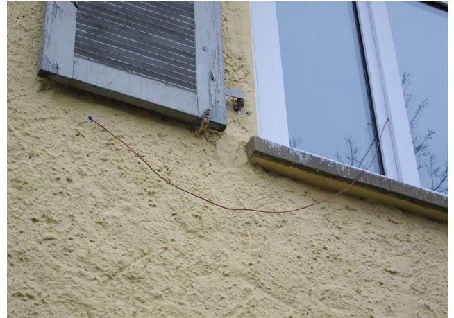
Abbildung 8.15: Außenaufnahme der U-Wert-Messung der Außenwand im unsanierten Fritz-Dächert-Weg 56-58. Die Abbildung zeigt den auf der Außenwand angebrachten Oberflächentemperaturfühler außen.
