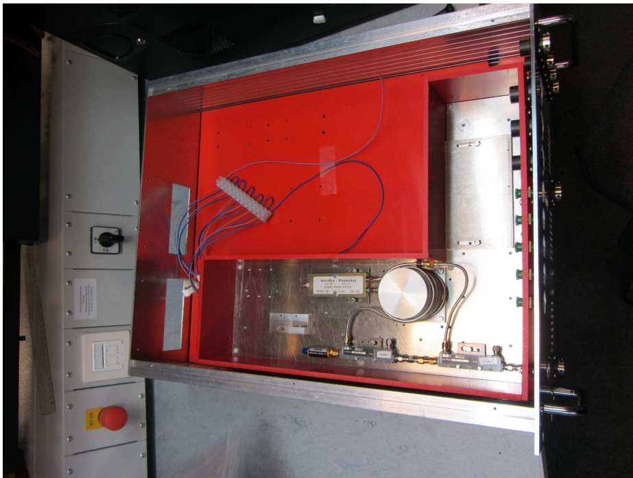
Abbildung A.18: Bild der BAM-Box mit eingebauter Aluminiumbodenplatte in der Thermobox. Innerhalb der Thermobox sind ebenfalls die zwei Richtkoppler und der Limiter (untere gekoppelte Kette) sowie die HF-Verzögerung (Kabelwicklung um den Zylinder) mit dem Phasenschieber (links neben dem Zylinder), welcher zur Feinjustage dient, montiert.
