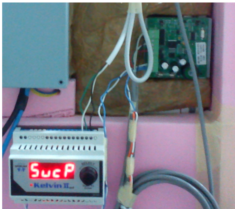
Figura 4.36: Controlador Kelvin II utilizado para medir la presión en la succión del compresor.
