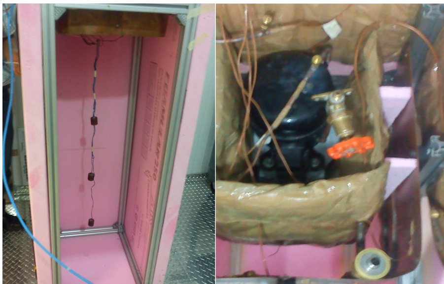
Figura 4.31: Transductores de presión instalados en las líneas de alta y baja presión del sistema de refrigeración.
