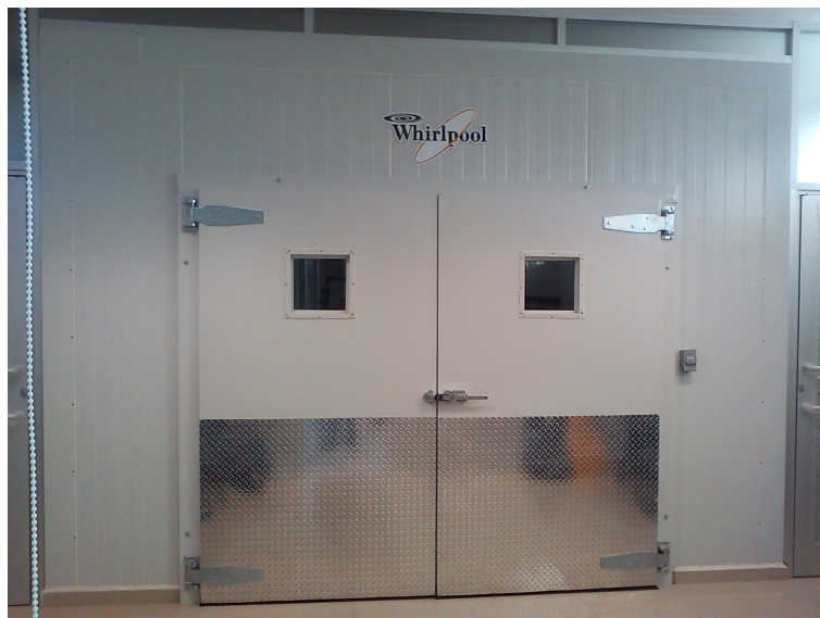
Figura 4.20: Cámara de ambiente controlado, en LIITE-FIME, Universidad Autónoma de Nuevo León
