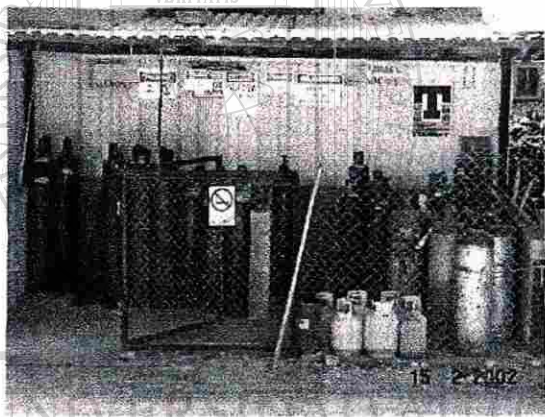
Materiales peligrosos utilizados en el proceso de construcción
