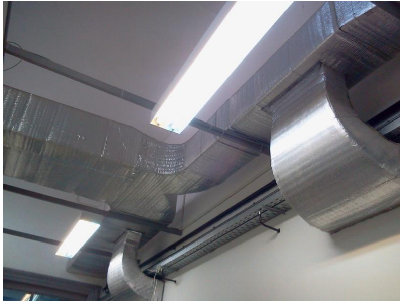
Foto 2: Tubería e instalaciones del aire centralizado frío / calor.
