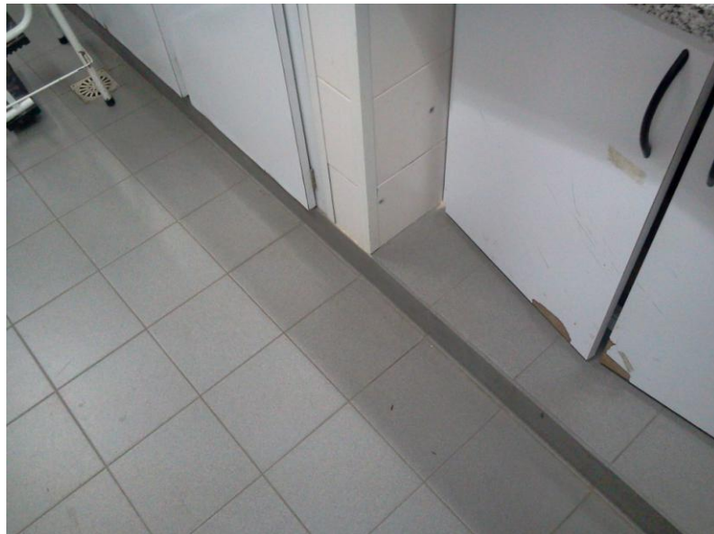
Foto 3: zócalos de bordes netos no redondeados lo cual no es lo indicado para los laboratorios de tipo II. Sin embargo, se comprende por la antigüedad del edificio (OMS).
