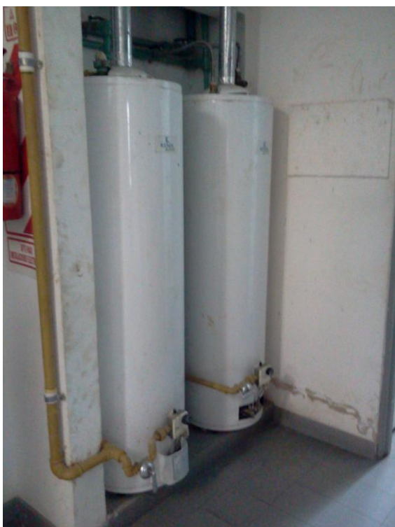
Foto 14: Sector de termotanques e instalaciones de gas bien compartimentadas. Los tubos de gas comprimido se acopian separadamente enganchados con cadena. Hay un matafuegos en el sector como puede observarse a la izquierda de la foto.
