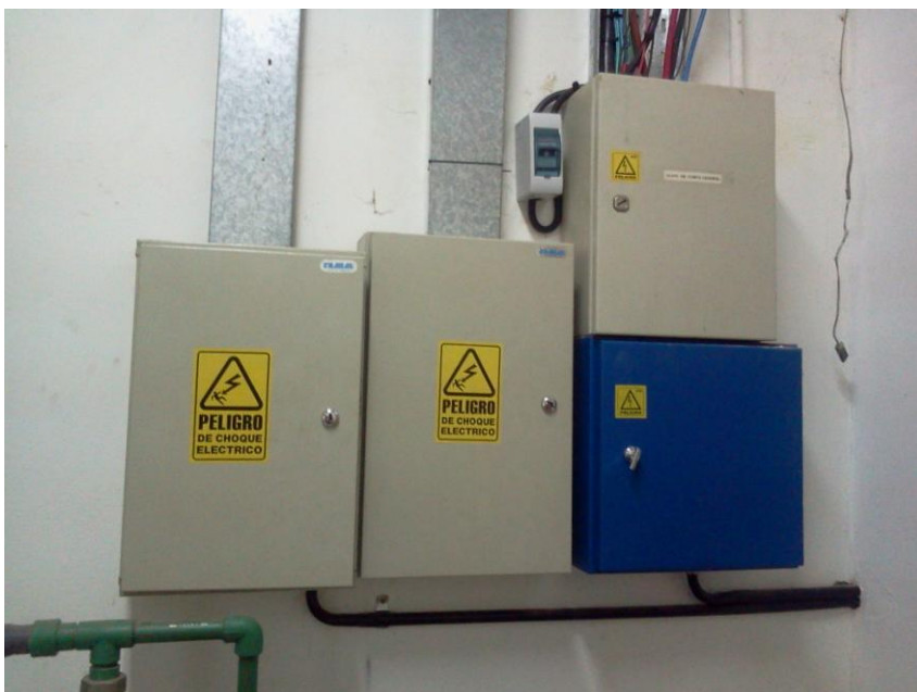
Foto 13; Zona de térmicas y celdas eléctricas bien identificadas
