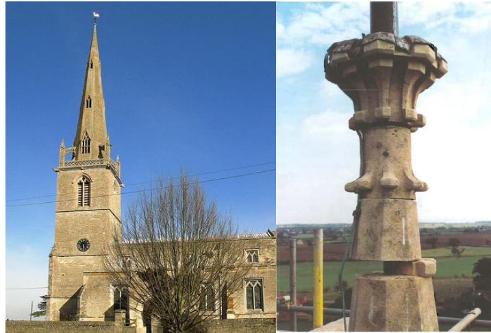
Fotografía 2. Iglesia de Easton Maudit en Northamptonshire, Inglaterra. Fotografía de la derecha: Daño causado por un impacto lateral de rayo.
