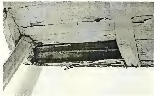
Fig. 8. Rot beneath the pole gutter.
