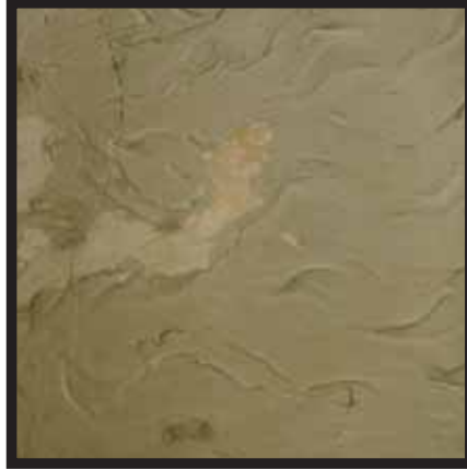
(d) stained plaster behind peeled paint
