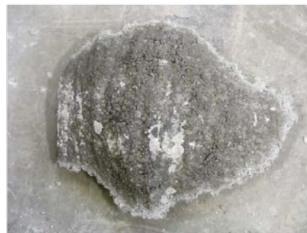
(d) Fully debonded patch
