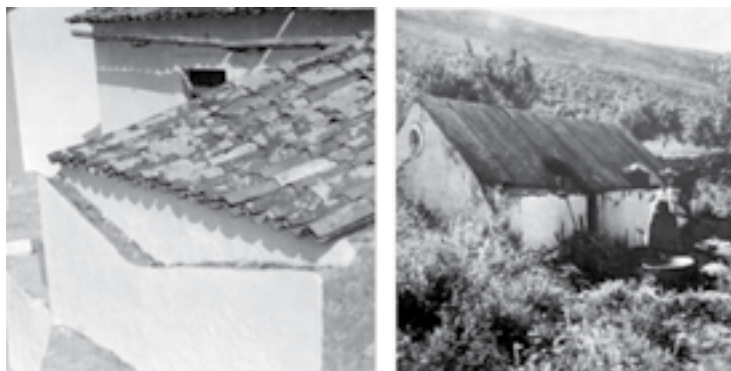
Figura 18 - (esquerda) Sistema de recolha de águas pluviais. mendiga, Porto de Mós; (direita) Habitação com caleira integrada na fachada para recolha de água. Mendiga [14]
