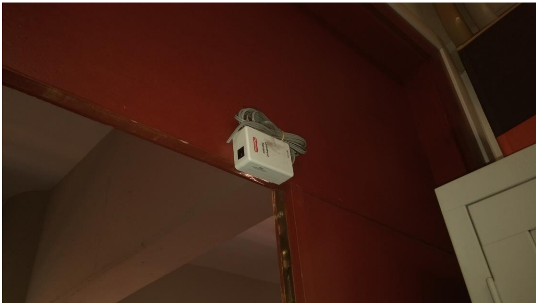
Figura 58. Instalación de sensor de apertura y cierre de puerta.
