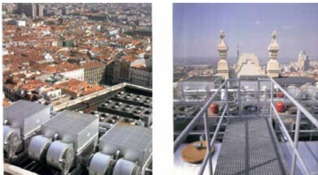
Figura 169. Fuente: Rehabilitación del Edificio de la Telefónica en la Gran Vía de Madrid, Dragados (1992). Maquinaria de Aire Acondicionado en las cubiertas del inmueble.
