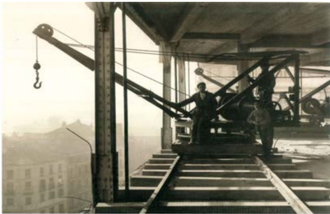
Alonso, 1927 Instalación de grúas en la planta 6ª. Edificio de Gran Vía, Madrid
