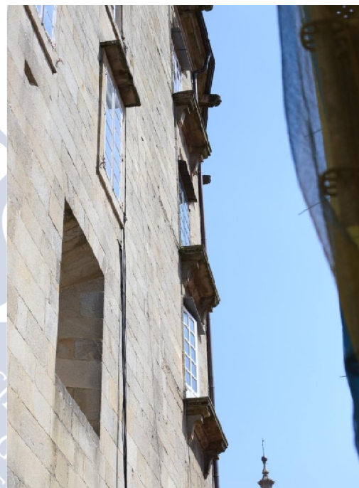
Figura 44: Balcones serrados en la fachada oeste, zona de la intersección entre la travesía de Dúas Portas y la calle Val de Deus.
