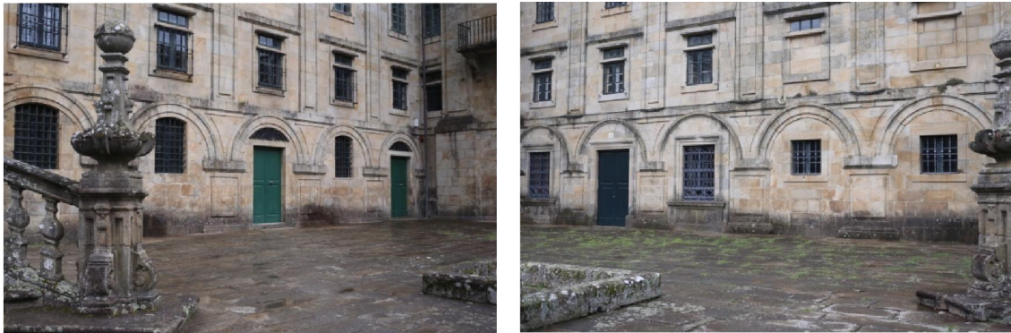
Figuras 29 y 30: Bajos derecho e izquierdo de la fachada principal.
