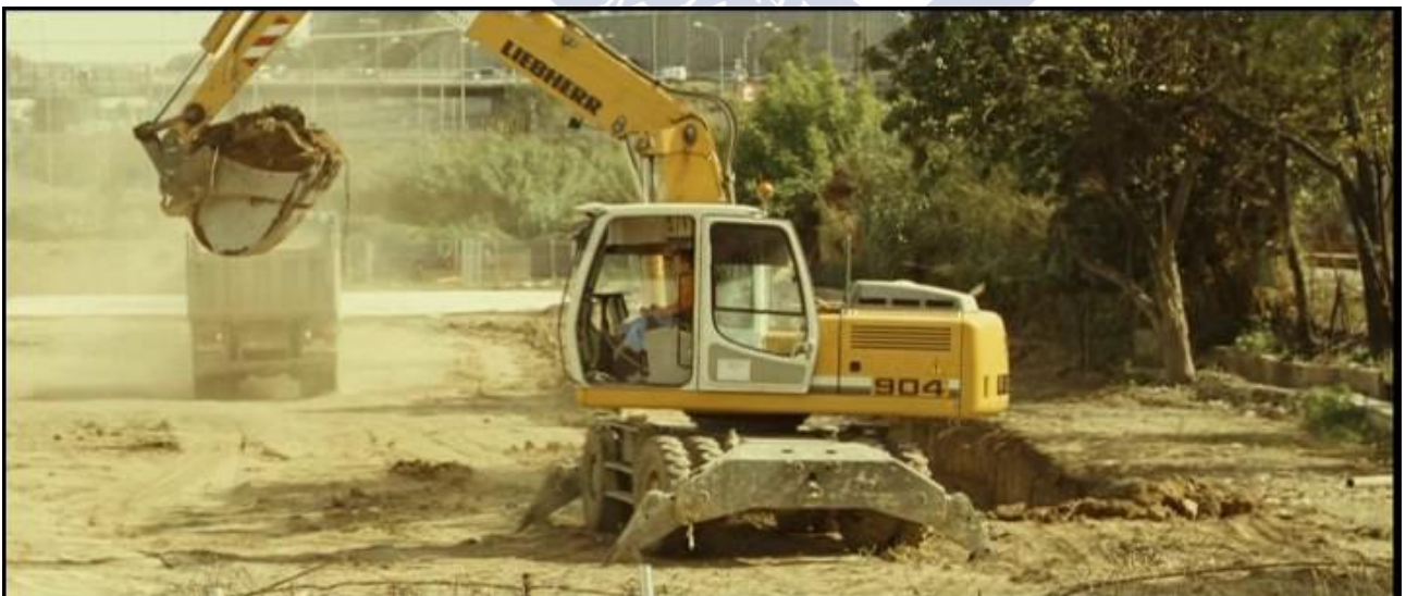
Imaxe 60: A excavadora en Petit indi sinala o avance do urbano sobre e contra o rural
