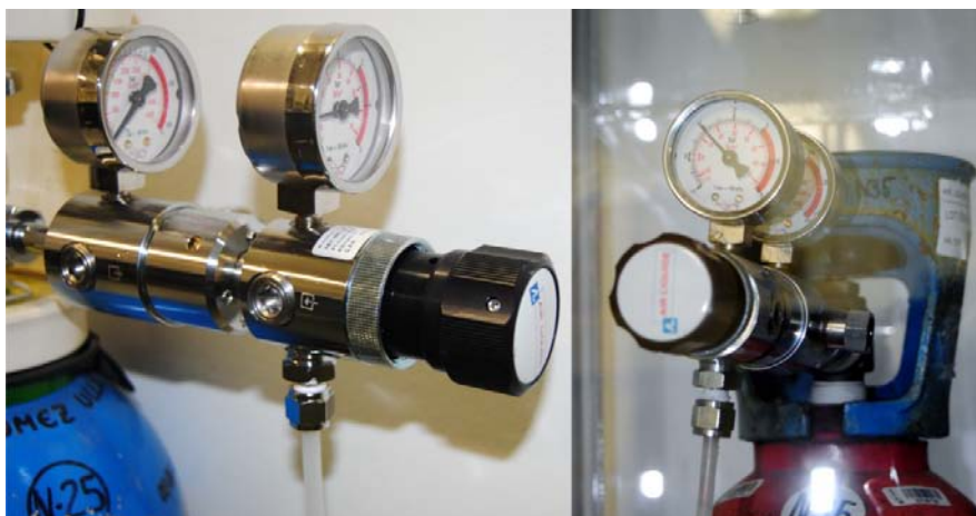
Figura 15: Manorreductor colocado a la salida de la bombona de metano. A la derecha se muestra que la presión que sale de la bombona de metano es de 1 Bar. A la izquierda la bombona está cerrada.
