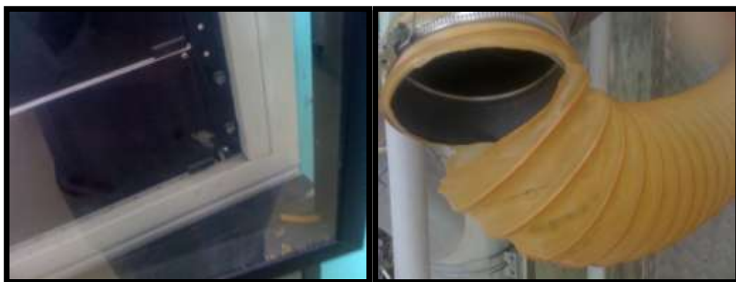
Figura 51: Restos de massas alimentícias no painel informático de uma das máquinas de embalagem (à esquerda) e aspirador danificado (à direita).
