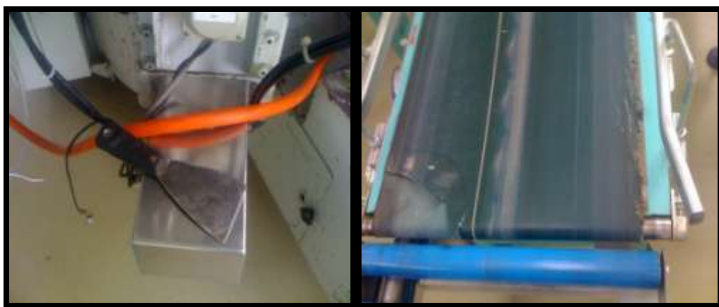
Figura 50: Espátula “esquecida” sobre uma das máquinas de embalagem (à esquerda) e banda de transporte danificada (à direita).
