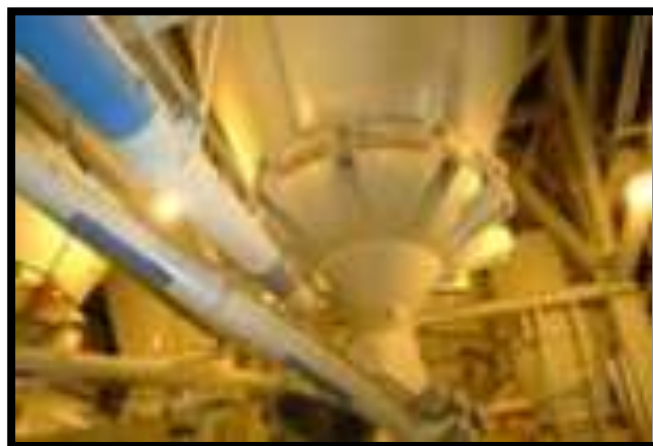
Figura 27: Sistema de dosagem.
