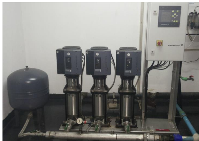
Figura 3. 6 - Funcionamento de eletrobombas.
