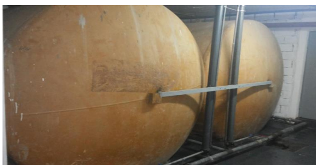
Figura 3. 3 - Depósitos da água bruta e da água potável.
