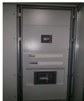
Figura 3. 22 - Quadro do arranque automático do grupo gerador.
