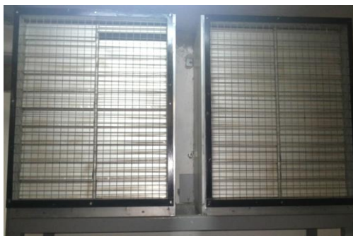
Figura 3. 20 - Ventiladores ligados ao grupo gerador.
