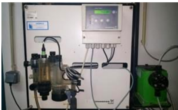
Figura 3. 7 - Equipamento de leitura.
