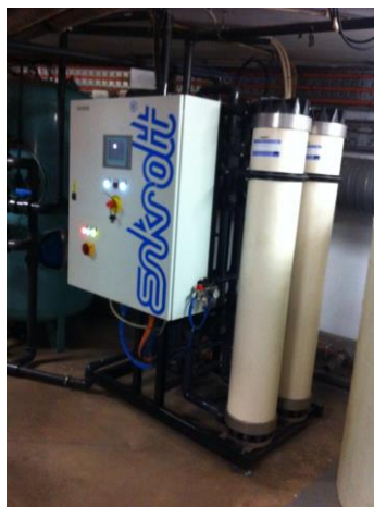
Figura 4. 6 - Filtros do sistema de tratamento de água recente.
