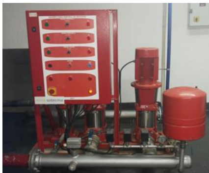
Figura 3. 11 - Sistema de bombagem de incêndio.
