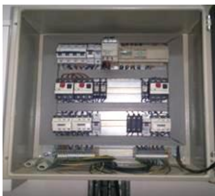
Figura 3. 13 - Disjuntor ligado ao sistema de ventilação.
