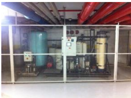
Figura 4. 4 - Central de tratamento de águas.
