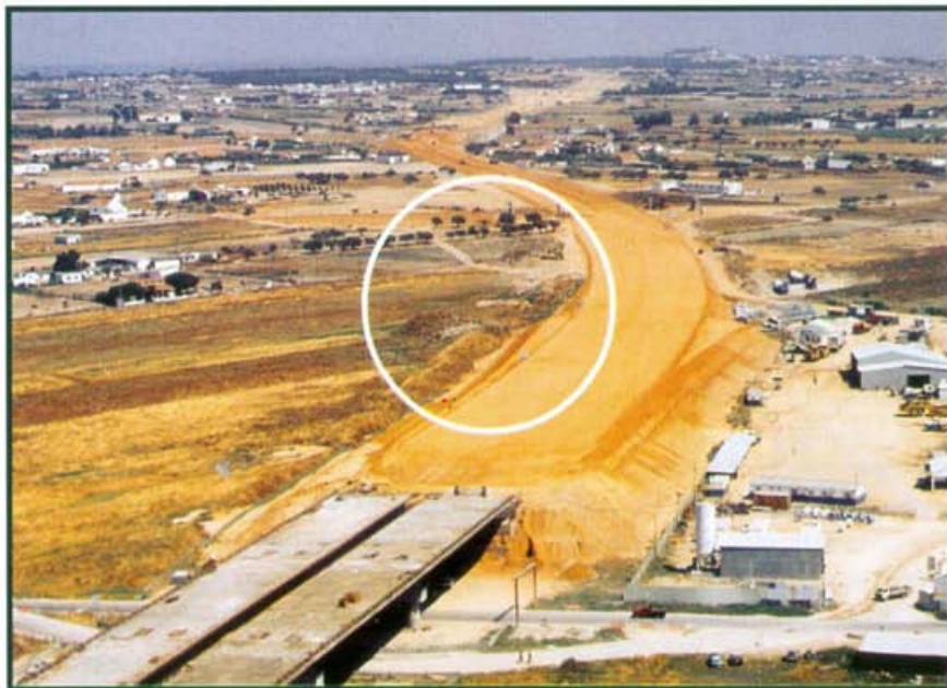
Figura 1 Fotografia aérea da zona envolvente do sítio da Conceição (assinalado com um círculo), quando se procedia à construção do aterro de acesso ao Viaduto Sul da Ponte
