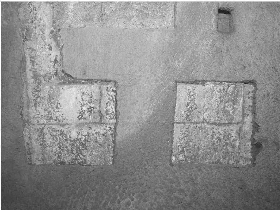
Fig. 7 – Pormenor de uma das áreas de picagem. Observa-se o arranque do arco bem como a largura do pilar de alvenaria de pedra que o suportava. Confirmou-se a qualidade da planta levantada por Leonardo Turriano, cerca de 1617/1618. Note-se a crosta dura e amarelada, cobrindo uniformemente a superfície da galeria, resultante da precipitação de carbonato de cálcio durante séculos.
