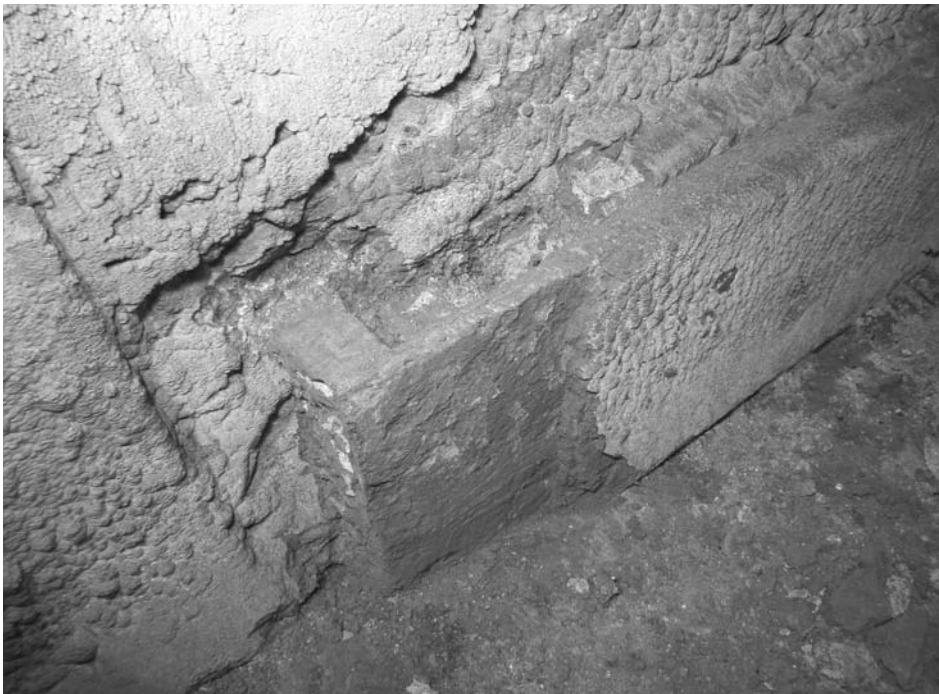
Fig. 9 – O último elemento localizado e por enquanto apenas parcialmente à vista. Parece tratar-se do topo de um tanque, provavelmente associado ao funcionamento do engenho de verrumar.
