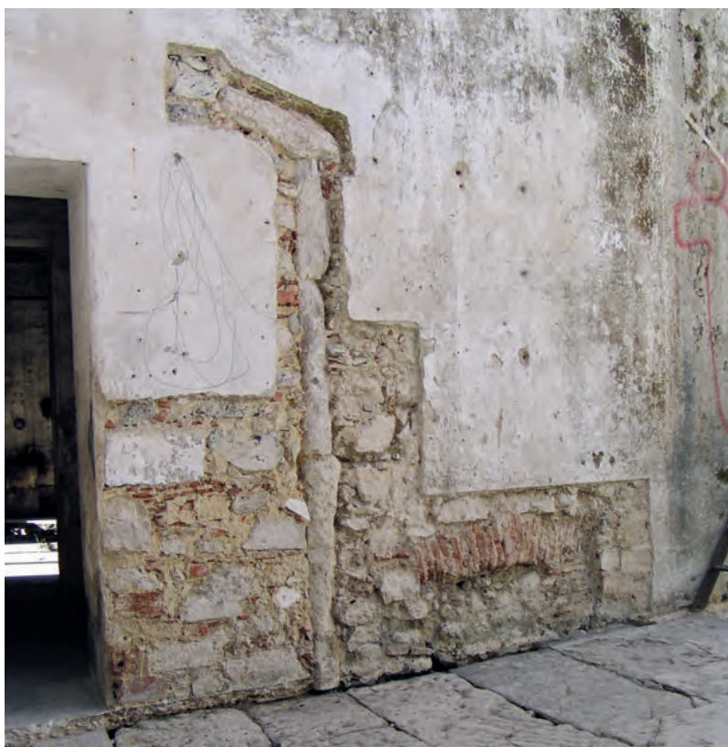
Fig. 4 – Ferrarias del Rey . Identificação, do lado direito da foto, da verga da porta do antigo edifício, em 2007, depois entulhado aquando da remodelação para fábrica da pólvora, sob a égide de António Cremer, na década de 1720/1730.
