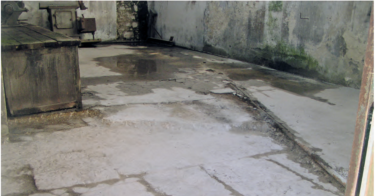
Fig. 9 – Ferrarias del Rey . Pormenor do chão primitivo da Oficina E do Edifício 33, depois de removida a camada de betonilha que o cobria.
