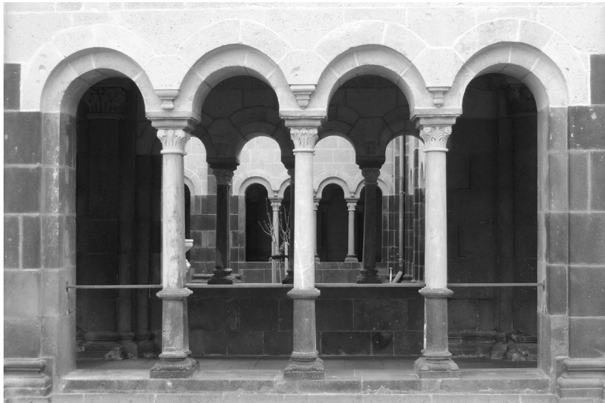
Abb. 3: Baukultur als Manifest des Handwerks: Arkade am Paradies des Klosters Maria Laach (Foto: Matthias A Schönbeck)
