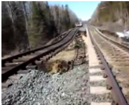
Figura 48 - Vulnerabilità funzionale: a seguito di un evento rilevante uno dei due binari risulta danneggiato riducendo la capacità della linea.
