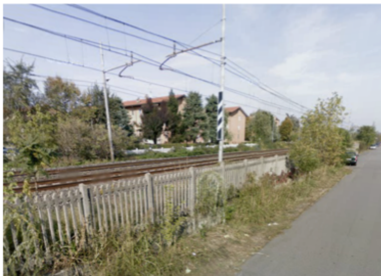
Figura 89 – Barriera ferroviaria valicabile.
