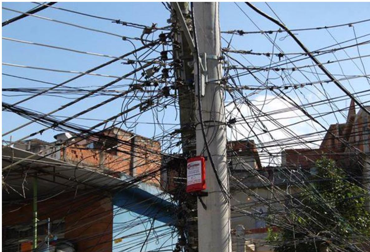
Foto 4.3. Fili elettrici nelle favelas
