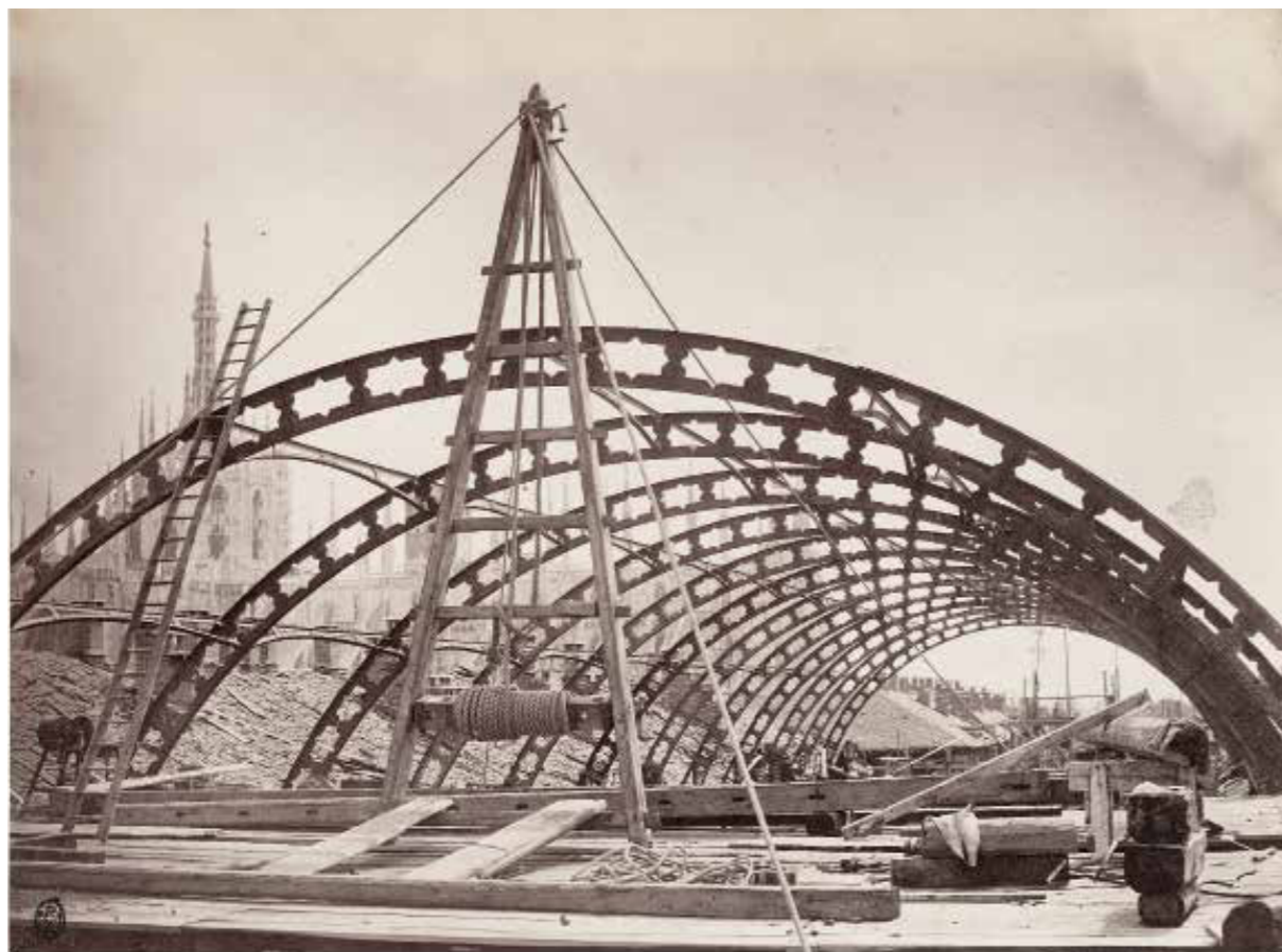
33. Costruzione della tettoia in ferro nel braccio settentrionale della Galleria Vittorio Emanuele II, fotografia Deroche & Heyland, agosto-dicembre 1866, CAFMi Albo G 107/27
